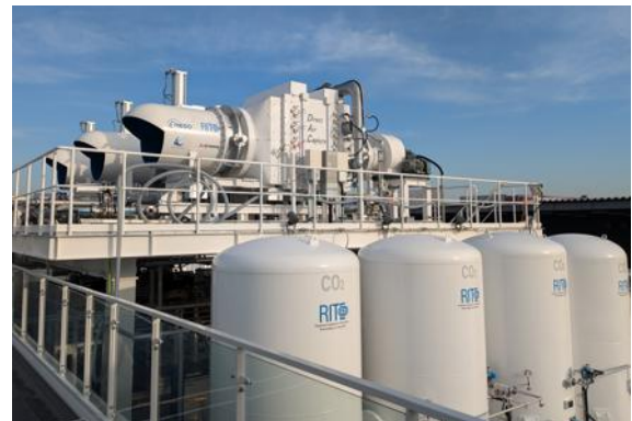
図4 CO 2 貯蔵タンク
