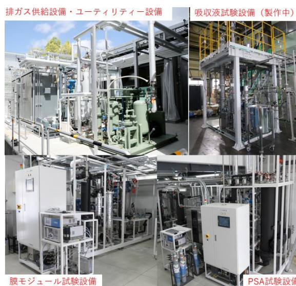
図3 炭素回収技術評価センター設備
