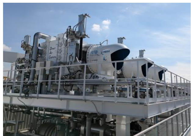
図4 大阪・関西万博会場に設置したパイロット試験機
