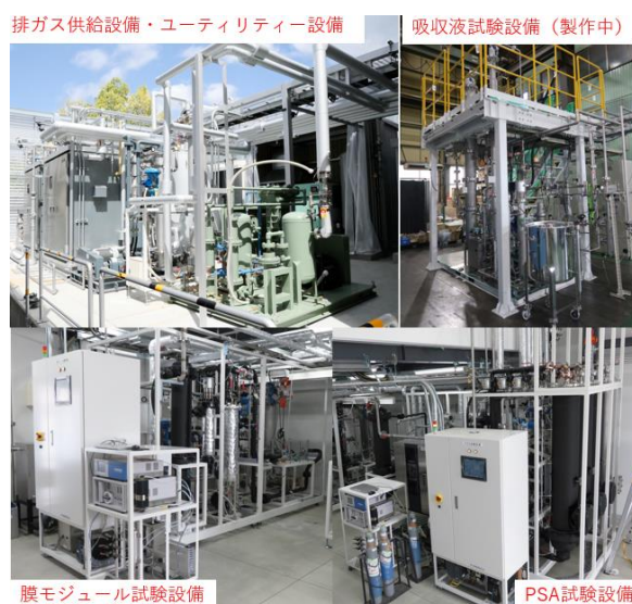
図3 炭素回収技術評価センター設備
