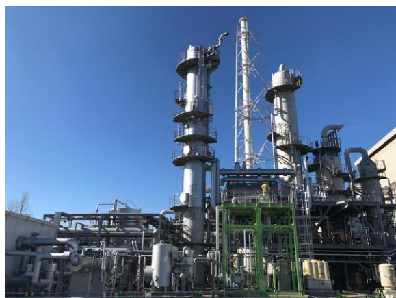
図1 省エネ型 \text{CO}_2 回収設備 ESCAP ® (住友共同電力株式会社新居浜西火力発電所内)
