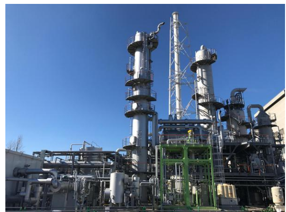
図1 省エネ型CO 2 回収設備ESCAP ® (住友共同電力株式会社新居浜西火力発電所内)
