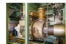
【アンモニアガスタービン】
