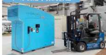
元町工場太陽光水電解 水素ステーションプロジェクト
