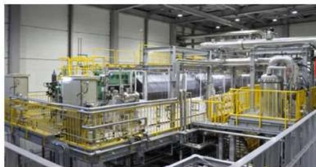
10MWの水電解装置
