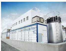
系統安定化のための蓄電池
