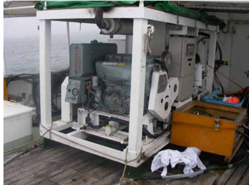
コンプレッサー
