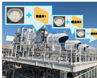
パイロット試験装置@大阪・関西万博
