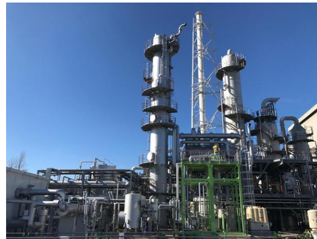
商業化2号機 (住友共同電力新居浜西火力発電所内)
