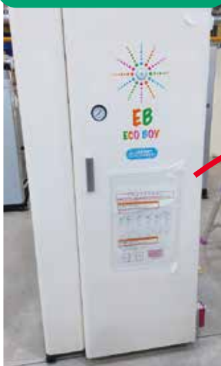
都市ガスボイラ
