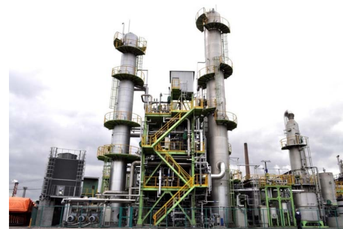
商業化1号機 (新日鐵室蘭製鉄所)
